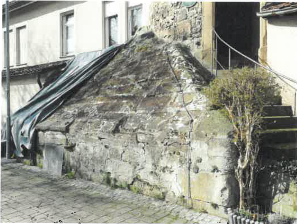
Bild 5: Abdeckmauerwerk des Gewölbekellers östlich des Turmes, Ansicht Nord-Ost; die Schutzfolie wurde für die Begutachtung kurzzeitig abgenommen
