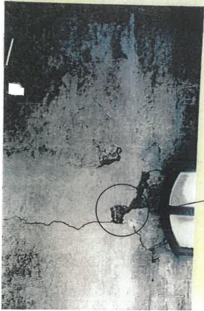
Gewölbetonne OG Riss in Tonnenschale West
