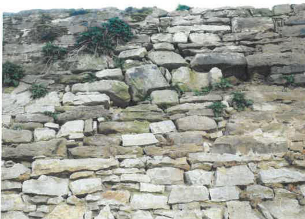
Bild 8: schadhafte und fehlende Verfügung; Fehlstellen im Mauerwerk; Bewuchs in den Fugen
