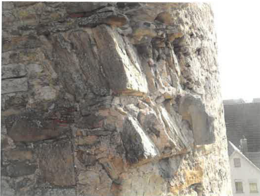
Bild 4: Ansicht der Schadstelle vom Gebäude Burgplatz 1 aus; Schäden an den Sandsteinoberflächen; loser Fugenmörtel und lose Mauersteine
