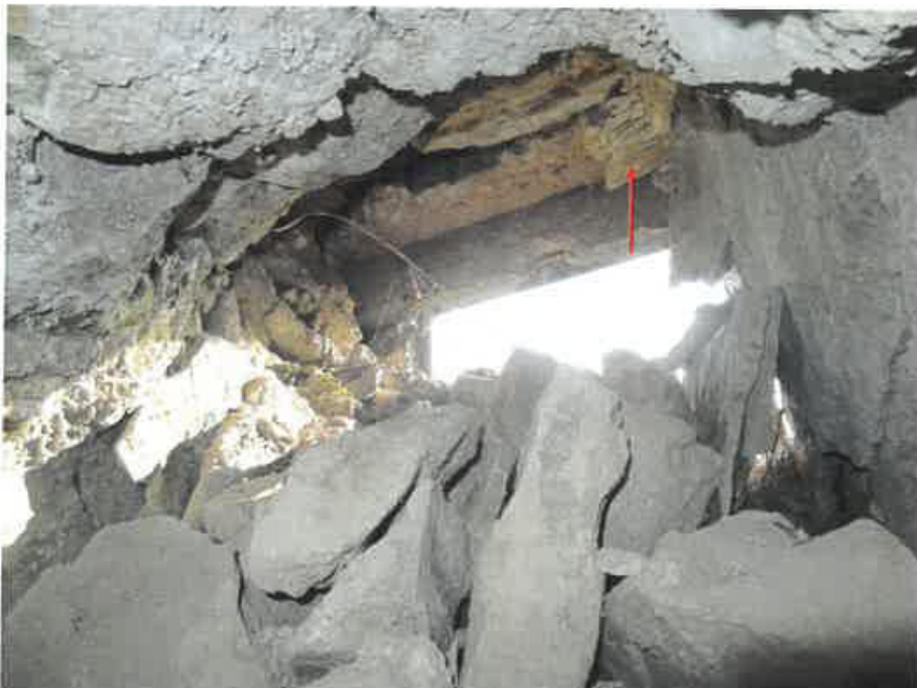
Bild 6: Lichtschacht, Ansicht vom Gewölbekeller; eingestürztes Mauerwerk im Bereich des Lichtschachtes; Betonsturz als Ersatz für abgebrochenen Sandsteinsturz
