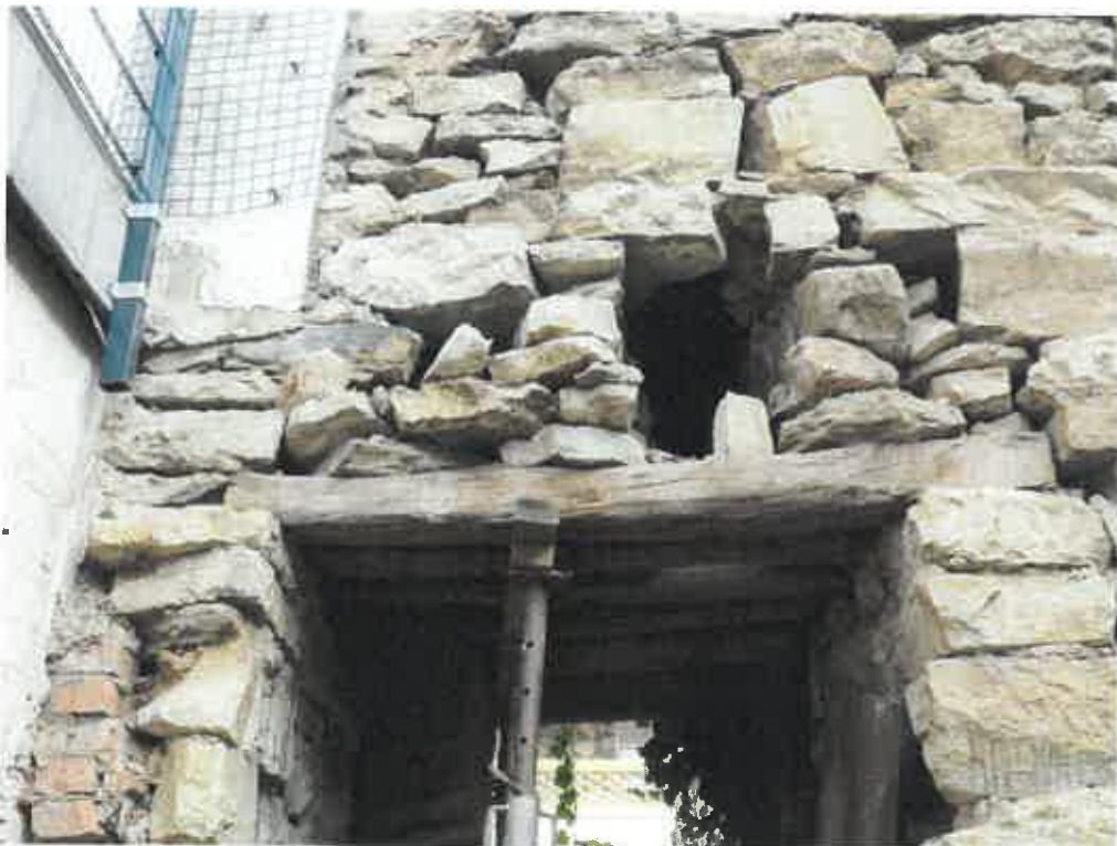
Bild 2: Detailaufnahme Mauerdurchbruch; Mauerwerk oberhalb des Durchbruchs mit starken Schädigungen \Rightarrow Tragfähigkeit nicht mehr gewährleistet; Holzstürze mit Notsicherung
